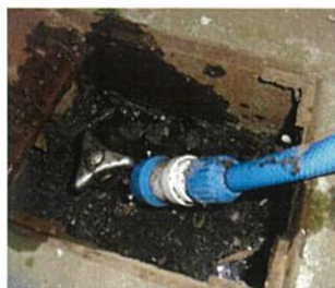
▲ 水の溜まった埋設型散水栓
